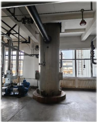
辽阳公司三基尾气吸收塔
